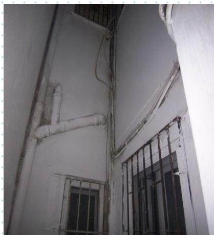
Εικ.2: κατακόρυφος σωλήνας αποχέτευσης σε φωταγωγό
