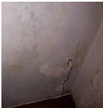
Εικ. 11: Ζημιά σε τοίχο διαμερίσματος από διαρροή σε κατακόρυφη υδρορροή.
